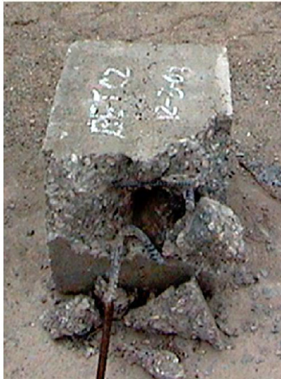
Foto 5.6. Falla por arrancamiento de un anclaje a tensión en un pedestal CON refuerzo de confinamiento.
